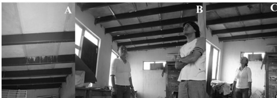
Figura 3.5. Espacio recubierto con el sistema Domozed, antes de colocar la capa de compresión, en la foto B, y después de colocar la capa de compresión, foto A y C.
