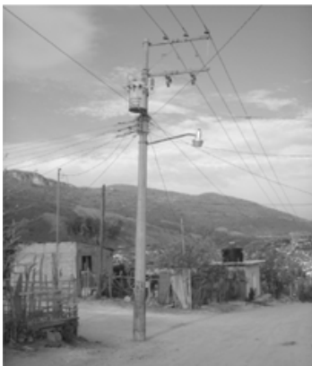
Figura 1.46. Condiciones de calles sin pavimentar, la red de energía eléctrica y alumbrado público. Fuente: Trabajo de campo.
