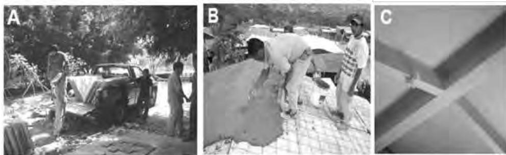
Figura 1.32. El sistema de techo Placa Losa. En la foto A, producción de piezas de este sistema en la facultad de arquitectura de la UNACH. En la foto B, construcción del techo para interior de la vivienda.
